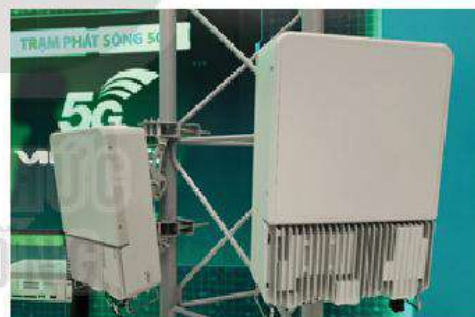
Hình 3.15. Trạm phát sóng 5G
