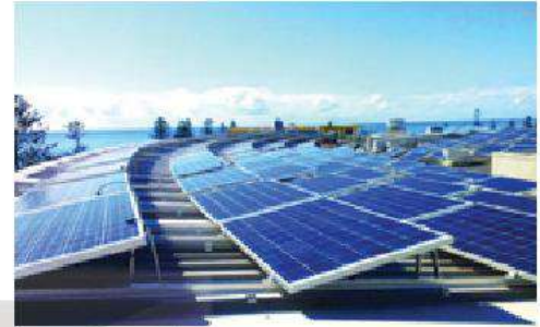
Hình 8.4. Nhà máy điện mặt trời Phong Phú, Bình Thuận
